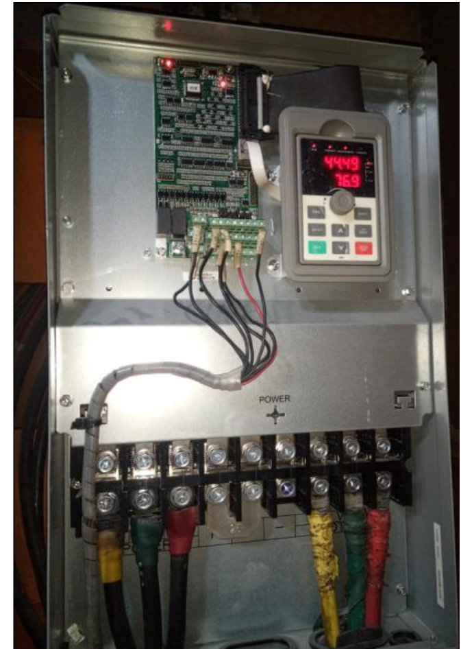
Powtran PI500 055G3 on site
